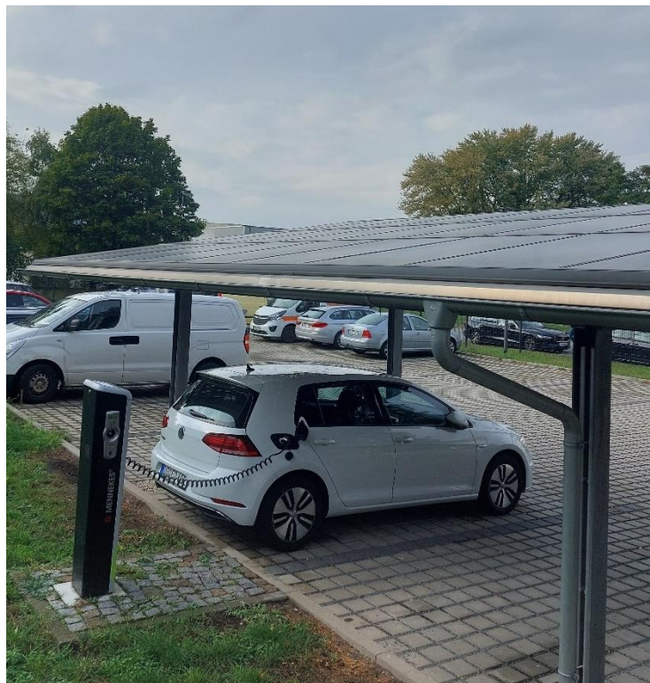
Abbildung 10-19: Eine von drei Parkplatzüberdachungen des EBZ (Foto: Thomas Pluntke)
